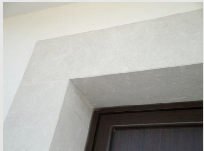
A sinistra particolare della muratura Sopra particolare dei rinfasci invecchiati delle aperture
